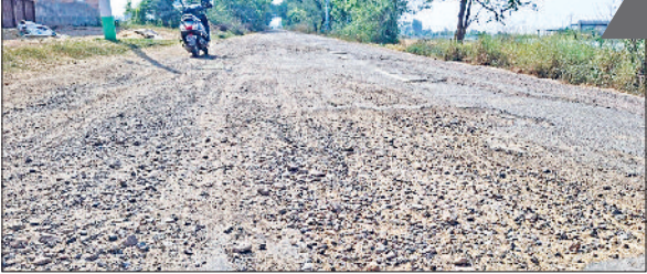
नारनौद। नारनौद से जुलाना सड़क मार्ग गांव खांडा खेड़ी तक टूटी हुई सड़क पर गड्ढे।
